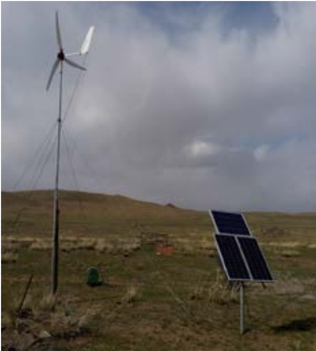
2013 年新能源升级改造工程 500W 升级到 600W
