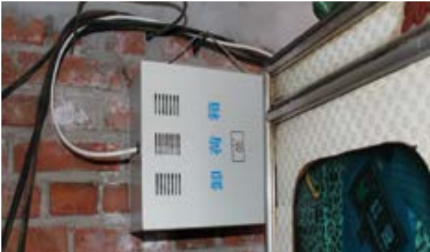
卸荷器安装位置不合理
