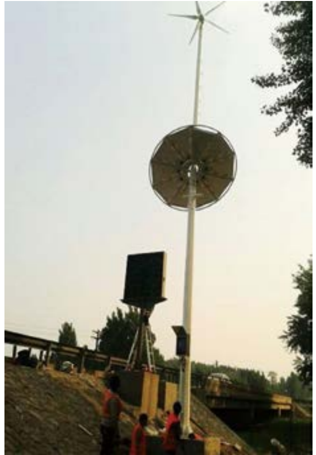
高速公路情报板供电系统
