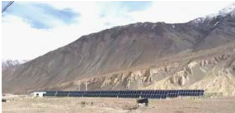
建成的西合休9村便民警务站电站
