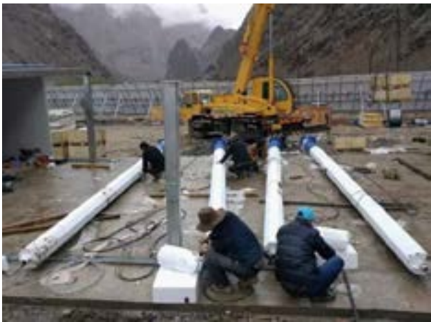
安装中的库地通讯基站电站
