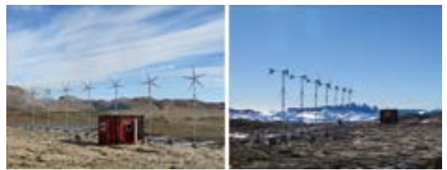
西藏那曲离网供电系统
