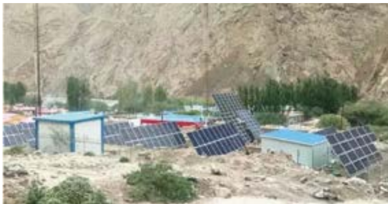
建成的库地通讯基站电站
