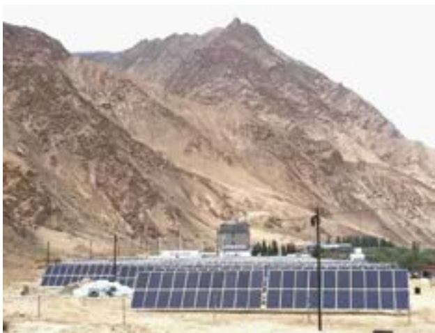
建成的库地检查站电站
