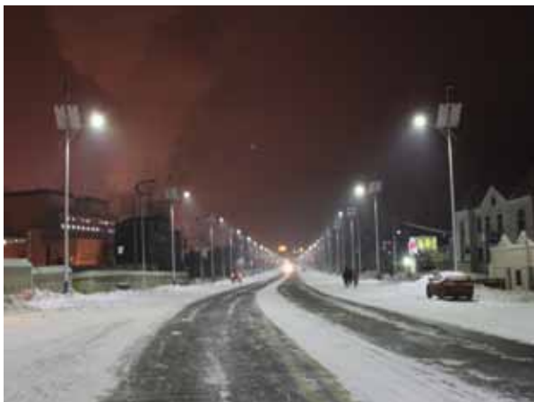
内蒙古地区海拉尔市风光互补路灯项目
