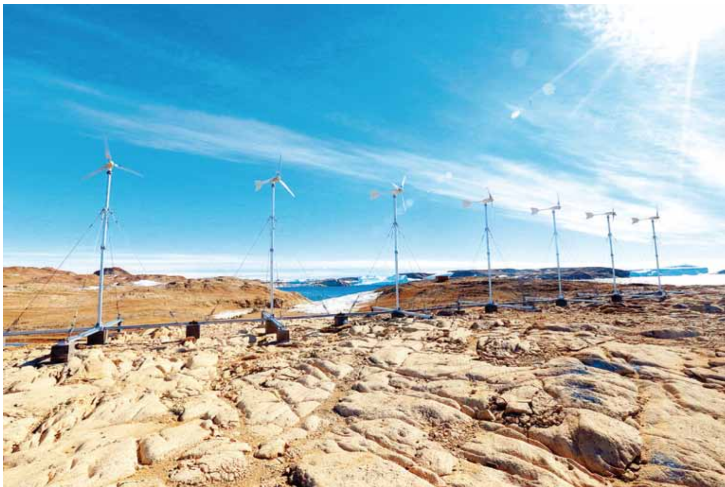
图为南极中山站站区“天鹅岭”上的风力发电机组（3月1日摄）。
